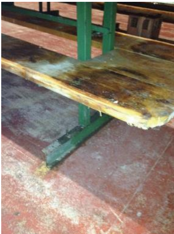
L'assenza del collegamento alla pavimentazione
