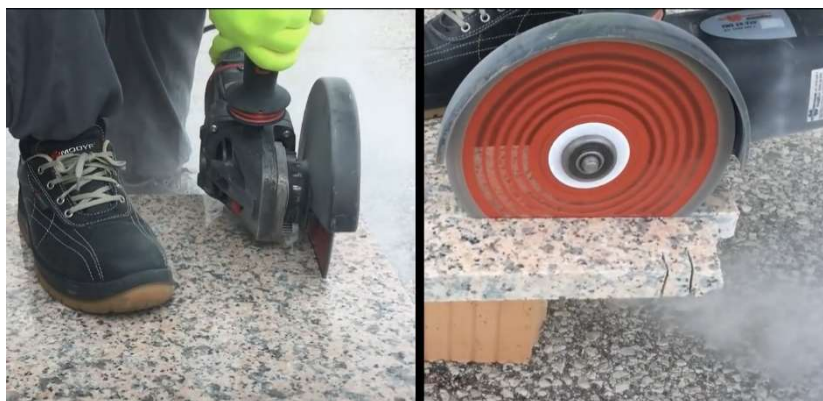
Figura 2. Esempio di taglio di lastra di marmo con flessibile manuale effettuata senza l'ausilio di specifici appoggi o fermi di sicurezza o banchi di taglio.
