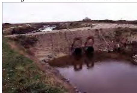
Diga di terra con botole richiudibili
